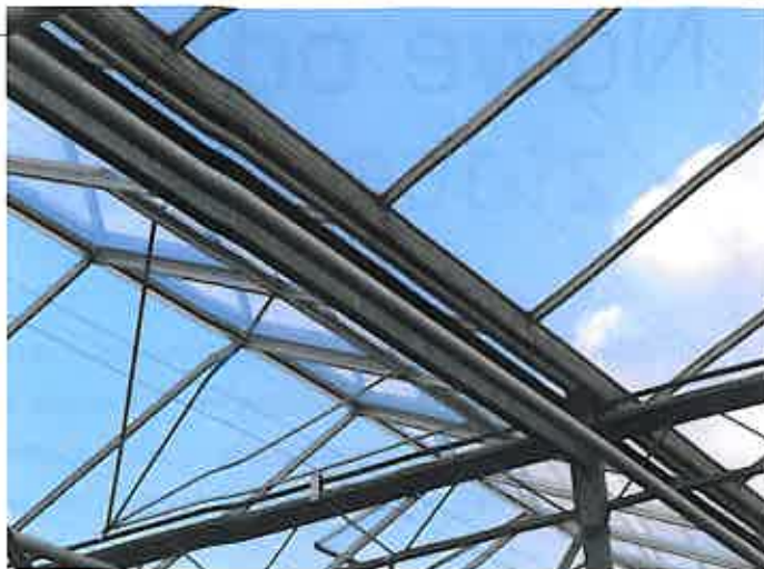
Fot. 12. Ogrzewanie podrynnowe m.in. zapobiega gromadzeniu się śniegu na dachu szklarni
